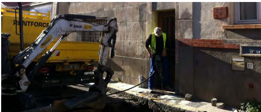
TRAVAUX A L'ECOLE DE PERPIGNAN : PLUS DE WC PENDANT UN JOUR DONC PAS D'ECOLE !
