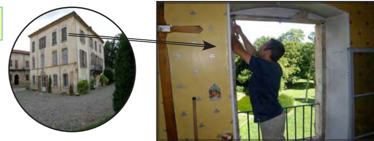
Mercredi 15 Septembre (fête de Notre-Dame des 7 douleurs) Branle-bas de combat au Prieuré : l'entreprise Bouzoum installe des fenêtres double vitrage à l'étage des chambres. Merci à tous nos bienfaiteurs !
