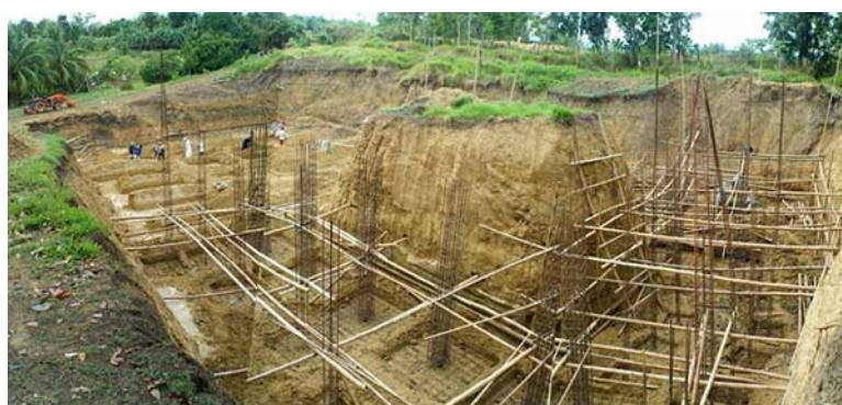
Le noviciat actuel, la maquette du projet d'église du noviciat des frères et les débuts des travaux
