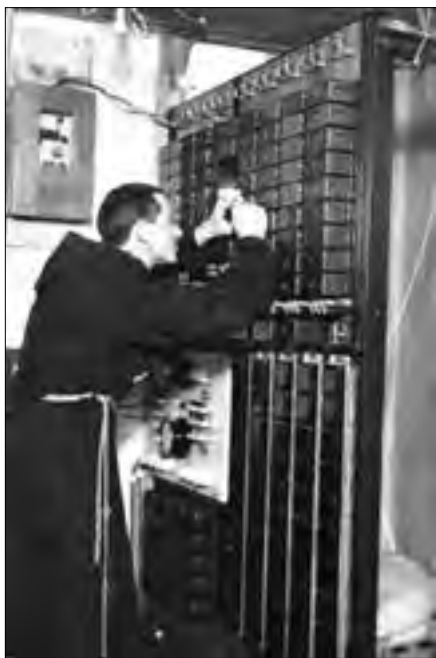
Le poste de contrôle électrique
