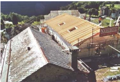
3. Der neue Dachstuhl. Die Renovierungsarbeiten ermöglichen uns die Konstruktion von fünf zusätzlichen Zimmern.
