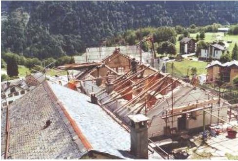
1. Abbruch des Daches unseres Hauses „Notre-Dame du Rosaire“ bei strahlend blauem Himmel.
