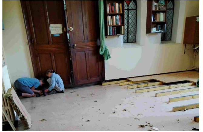
Le plancher bois était posé sur des tasseaux
